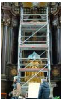
Fig. 38. Les conditions d'une intervention in situ doivent être cadrées dès le départ par la fabrique d'église et le professionnel de la conservation-restauration retenus.
