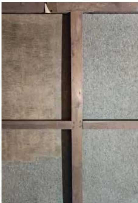
Fig. 55. En cours d'aspiration des moisissures : partie gauche aspirée, partie droite non aspirée.
